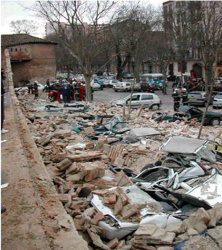
Mardi 25 février 2003 après midi. Rafales d'autan env. 120km/h. Effondrement d'une partie du mur d'enceinte en brique de la cité administrative à Toulouse sur une longueur 30 mètres. Environ 25 véhicules broyés. Pas de victimes...
